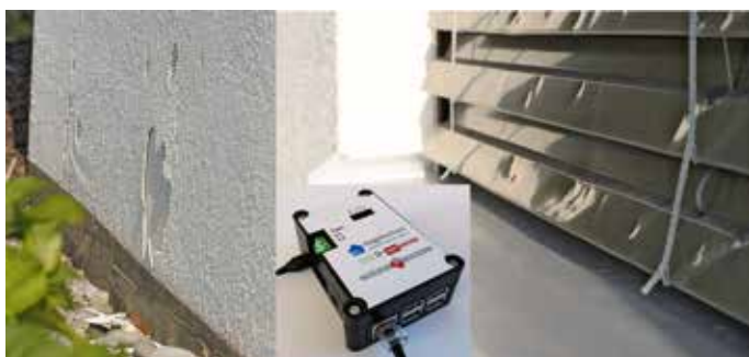
Abb. 2: Hagelschäden an der Gebäudehülle (links: aufgeschlagener Putz an WDVS, rechts: zerbeulte Lamellenstore) lassen sich einfach verhindern, mit der Verwendung hagelsicherer Bauteile (hagelregister.ch) und einer automatischen Hagelwarnung für Lamellenstoren (Mitte: Signalbox zur Nachrüstung von «Hagelschutz – einfach automatisch» an bestehende Gebäude).
