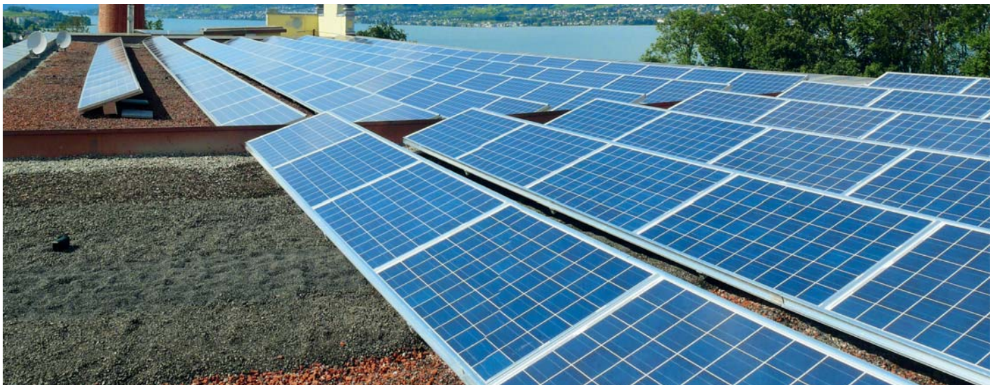
Photovoltaikanlage auf dem Flachdach der Einsiedlerstrasse 34 in Wädenswil. Im Vordergrund sind die Versuchsfelder mit verschiedenen Substraten zu sehen.
