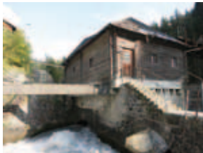
Die faszinierende, aber sanierungsbedürftige Anlage Pradapunt.
