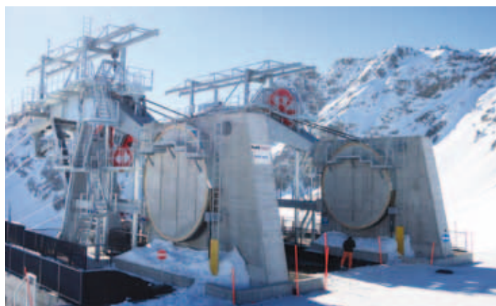
Die 2014 in Betrieb genommene Urdenbahn ist auch eine technische Attraktion.
