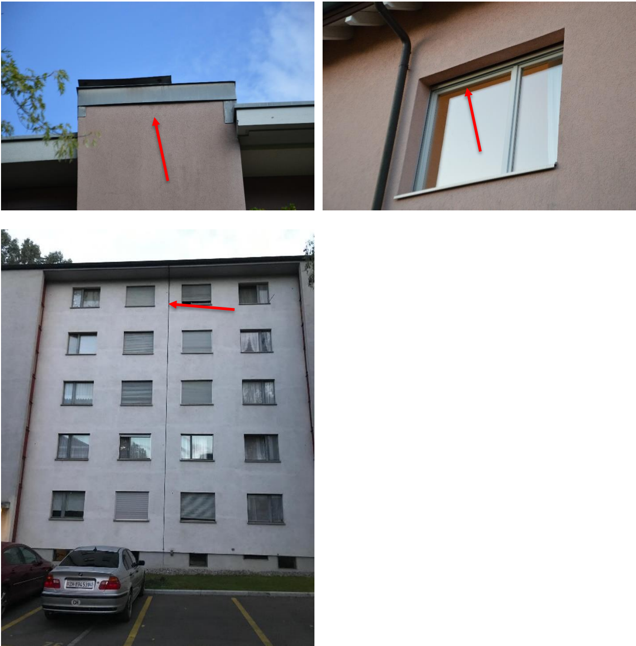
Abbildung 5: Die Quartiertypen Blechabzug Flachdach (rechts oben), Rollladenkasten (links oben) und Mauerspalte (links unten).
