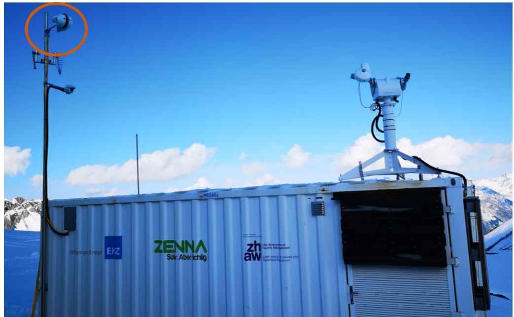
Abbildung 5: Vertikale Einstrahlungsmessung aus östlicher und westlicher Richtung, in Betrieb seit 1. Oktober 2020 am Messmast des Containers. Die Sensoren befinden sich oben links im Bild.
