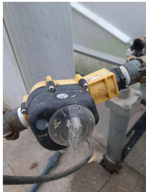
Abbildung 13: Wasserzähler, mit der die Bewässerung im Tunnel gesteuert wurde.
