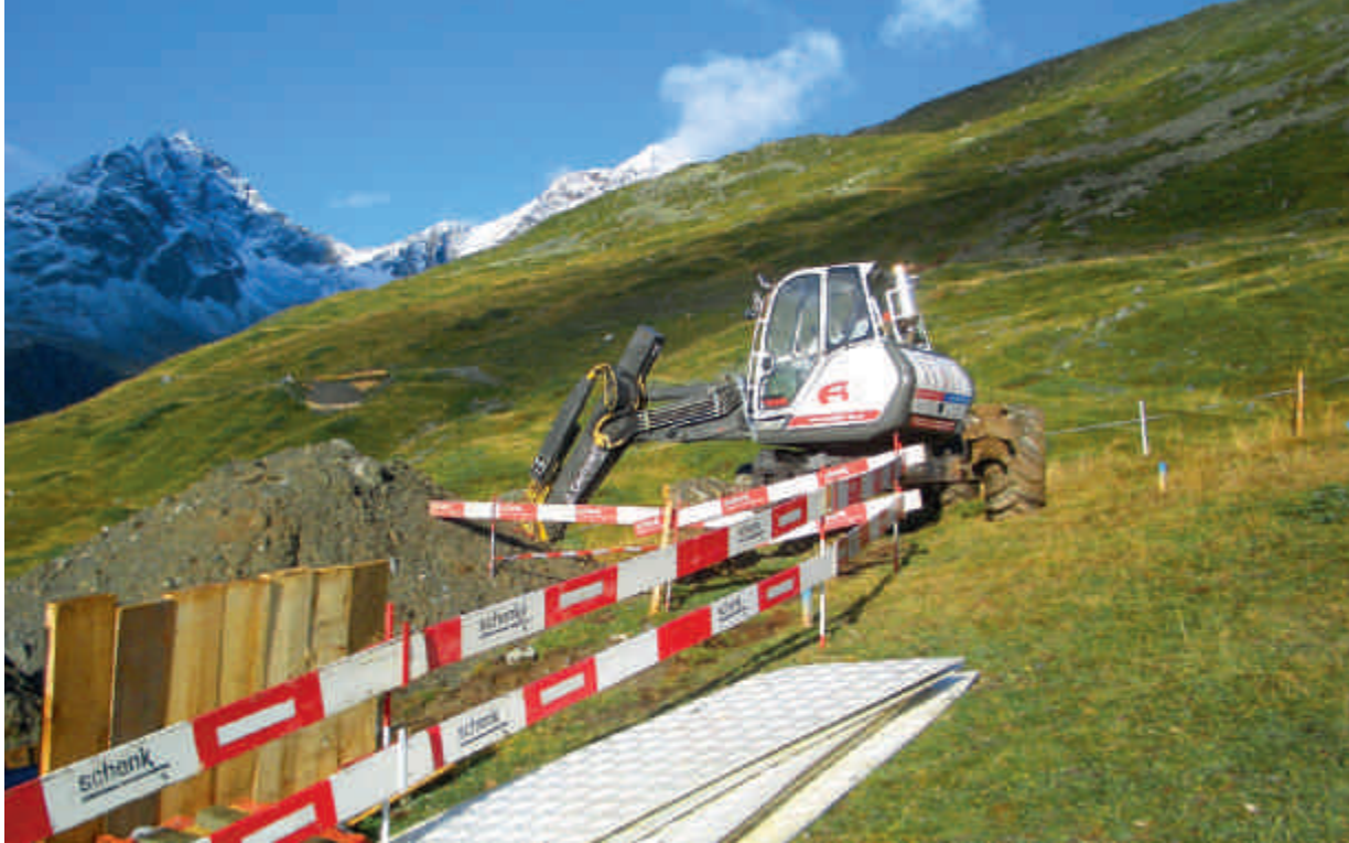
Statt eines Grabens quer durch das Moor nur zwei Löcher: Leitungsbau im Bohrverfahren.
