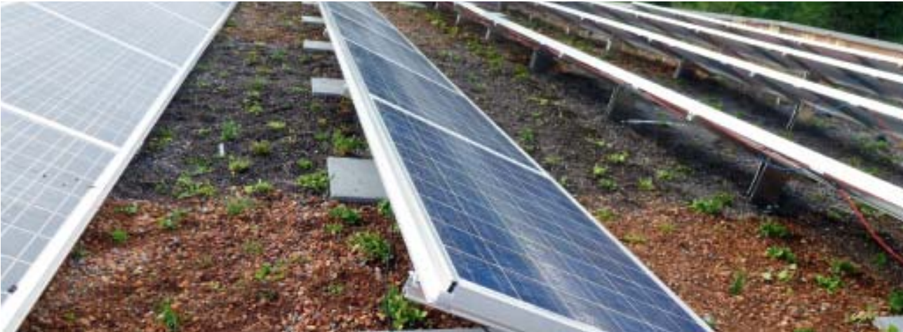
Beim Versuch zur Begrünung mit Stauden im Bereich einer Photovoltaikanlage wurden auch verschiedene Pflanzsubstrate untereinander verglichen.
